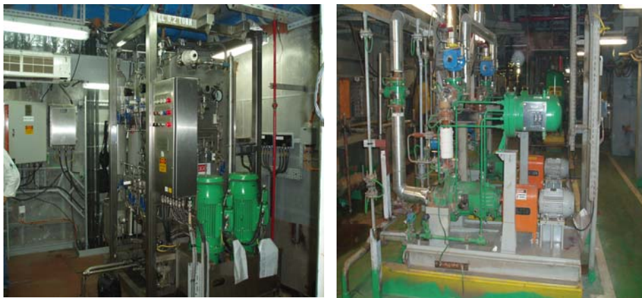
Figura 15: Exemplos de Skid : Sistema de Controle Remoto – REMOCON 29 e Sistema de Bombas, respectivamente, obtidos em visita à P-51
