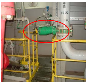
Figura 33: Válvula do sistema de Lastro
