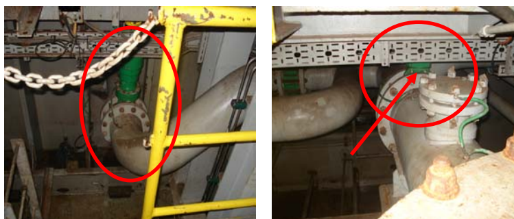
Figura 32: Válvulas do sistema de Lastro
