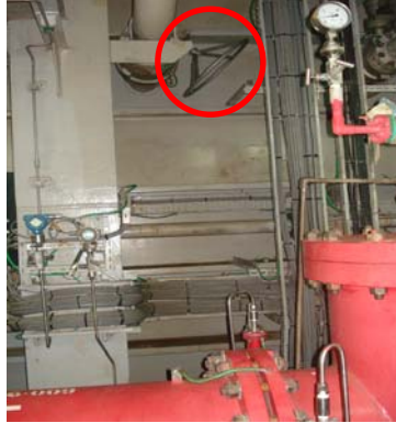
Figura 29: Válvula do sistema de Diesel
