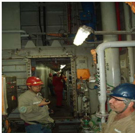
Figura 8: Fotografia de parte da pump room e entrada do túnel de acesso do pontoon da plataforma P-51
