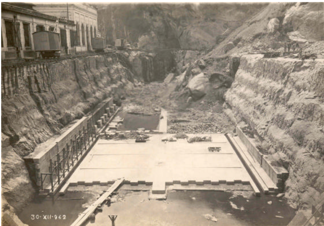
Figura 17 – Obra de ampliação do dique Guanabara (atual dique Almirante Jardim), em 30-12-1942 - Fonte: SDM.
