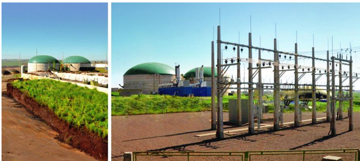
Figura 17 – Usina com rede elétrica geração distribuída - Fonte Geoenergética
