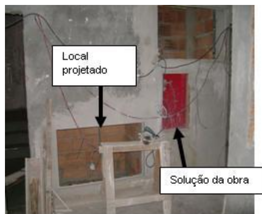
Figura 37 – Vista da caixa de incêndio
