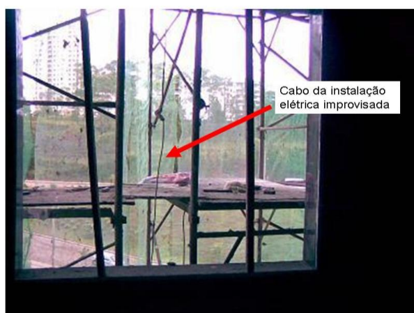
Figura 66 – Instalação elétrica improvisada
