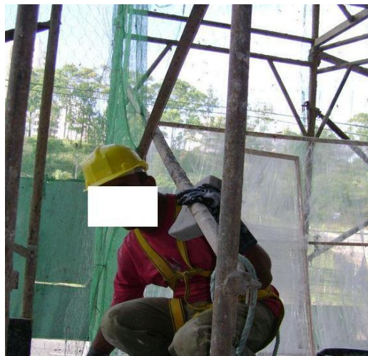
Figura 72 – Falta de espaço para assentamento de granito
