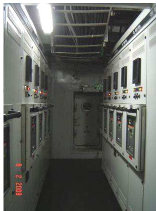
Figura 60 – Sala de painéis (iluminação insuficiente e luminárias que geram reflexos)
