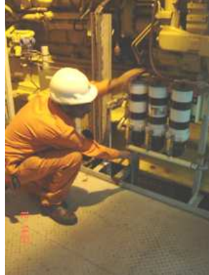
Figura 66 – Alinhamento do diesel
