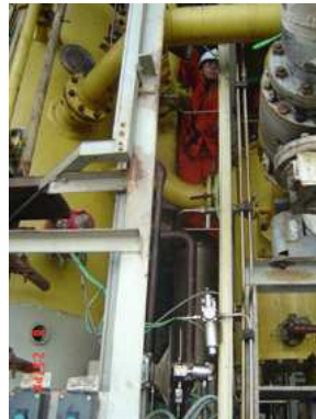
Figura 54 – Falta de acesso para acionamento de dispositivo
