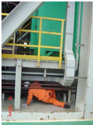
Figura 13 – Válvula de dreno abaixo do HOOD
