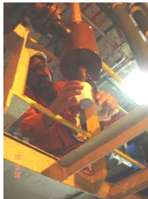
Figura 68 – Dreno do óleo condensado junto ao ar de escape
