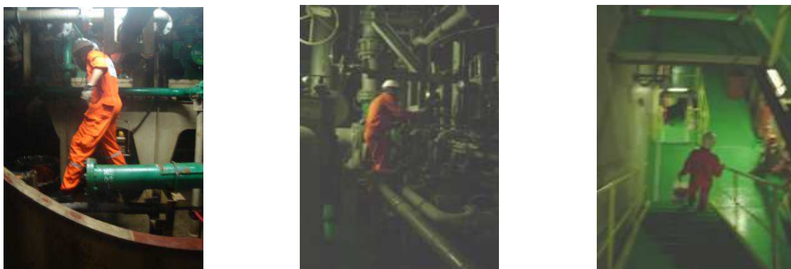
Figura 50 – Casa de Bombas
