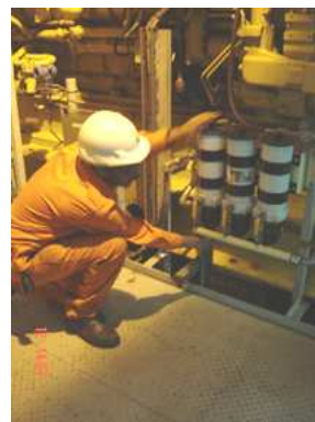
Figura 88 – Alinhamento do diesel
