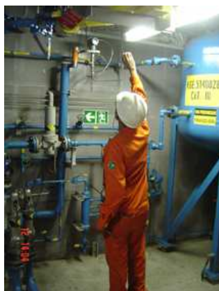
Figura 64 – Verificação da pressão de ar de partida
