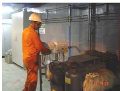
Figura 65 – Compressor de ar de partida
