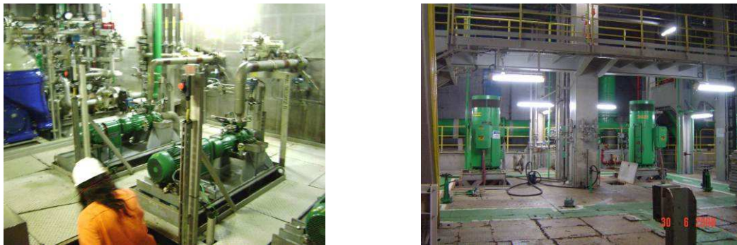
Figura 47 – Visão geral da sala de utilidades
