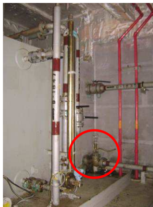
Figura 70 – Válvula de dreno do tanque de diesel
