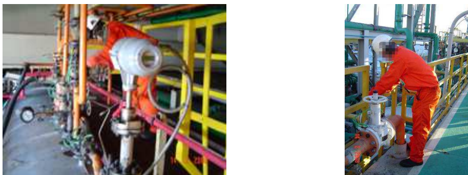
Figura 6 – Manipulações de válvulas na transferência de glicol
