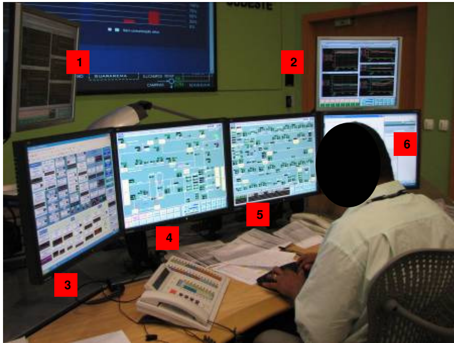
Figura 14: Posto de trabalho do operador SE com os seis monitores do console e o videowall ao fundo
