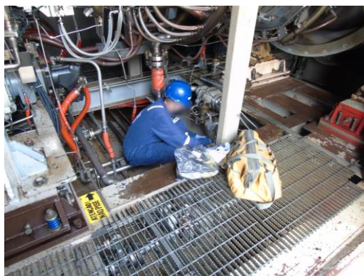
Figura 33 : Verificação na válvula de Gás UG14
