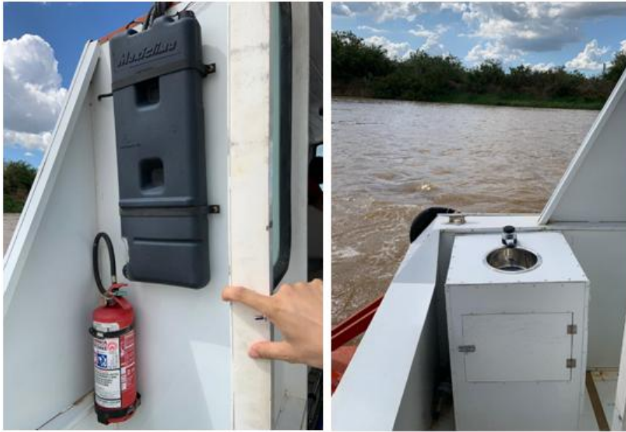
FOTO 17: Vistas da popa da embarcação de B JL: tanque de água do ar condicionado e pia
