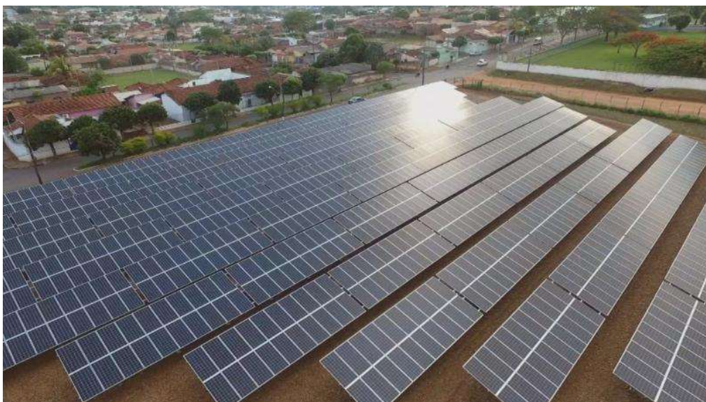
Figura 1: Usina Solar Fotovoltaica Fonte: Portal G1 da Globo (2019)
